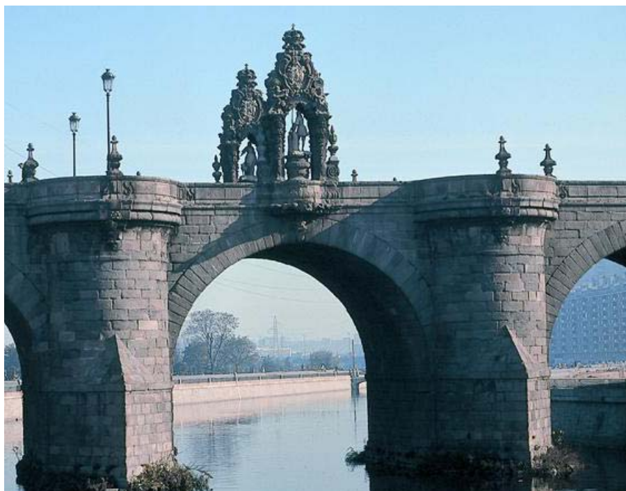
Figura 3: El Puente de Toledo sobre el río Manzanares (Madrid) obra del arquitecto Pedro de Ribera, fue construido entre los años 1718 y 1732
