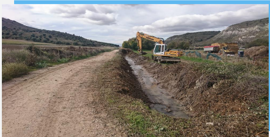
Trabajos con maquinaria dentro del DPH generando aumento de erosión y turbidez.
