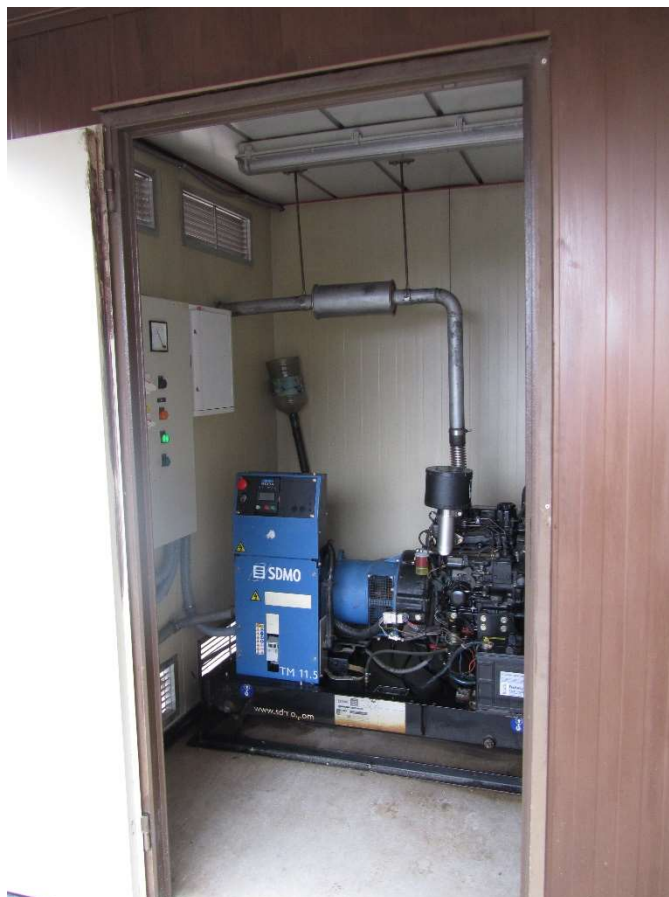
Grupo electrógeno presa de Navamuño
