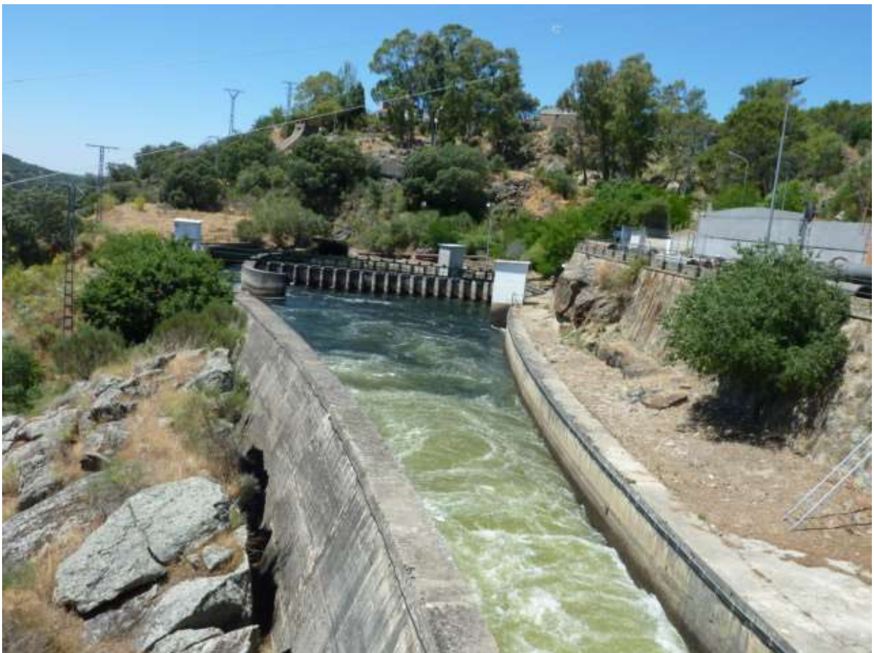
Canal Venturi en la toma del Canal principal del Alagón
