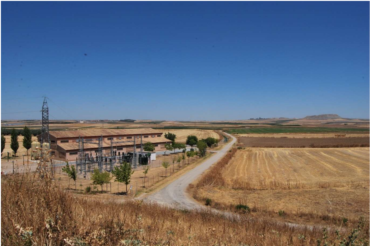
Estación elevadora Z.R. La Sagra-Torrijos
