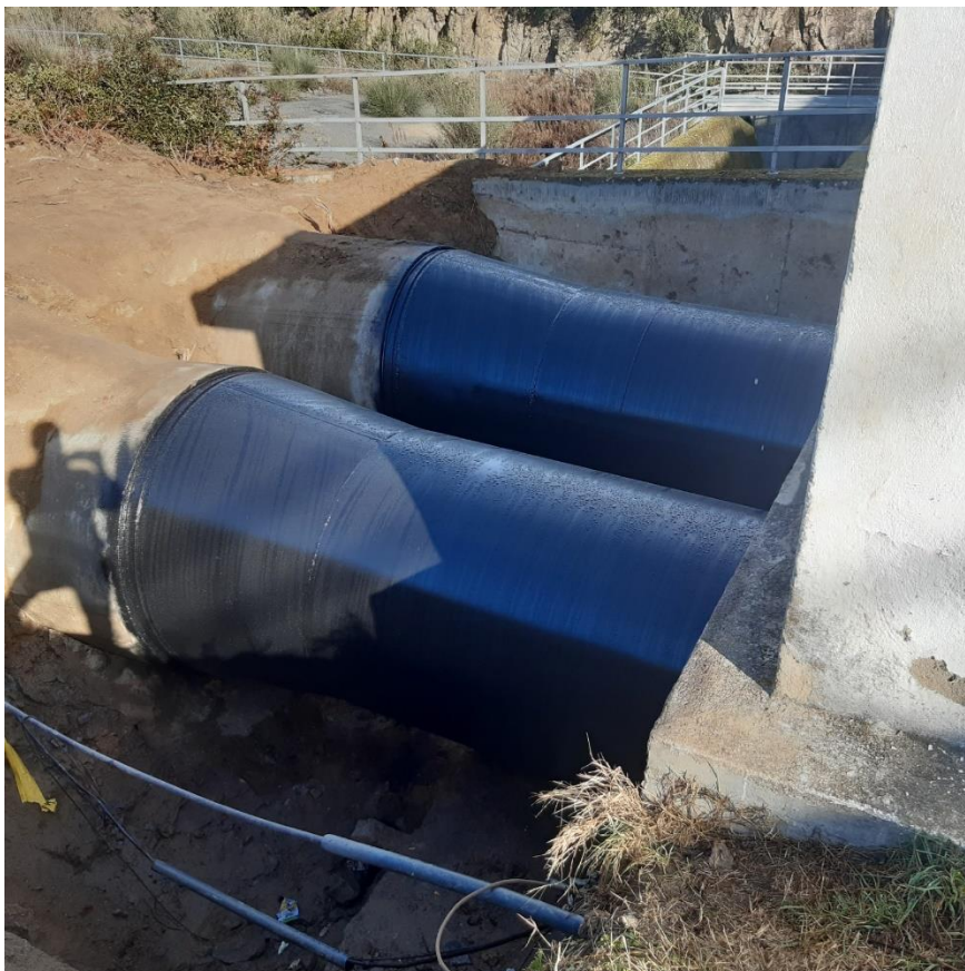
Imagen: Nuevo tramo de tubería de impulsión y de toma de riego, al pie de la Balsa de Alcolea
