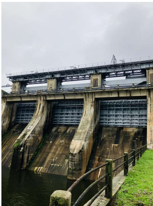
Vista aguas abajo del aliviadero de la presa de Rosarito, con las compuertas y elementos metálicos tratados con pintura antioxidante
