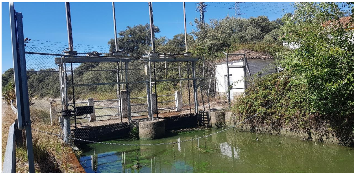
Compuertas de regulación del Canal Bajo del Alberche en arroyo La Portiña.
