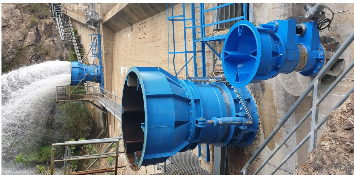
Presa de Picadas. Desagües de fondo con nueva válvula HB \phi 400 para el vertido del caudal ecológico.
