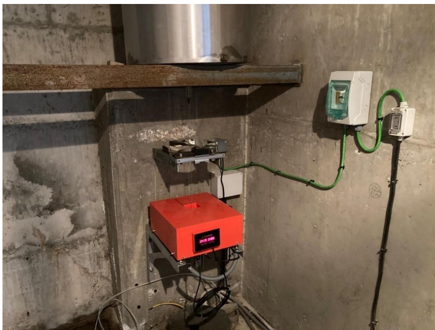
Mejora de la auscultación en la Tajera. Instalación de teleplancheta óptica para medición de desplazamientos mediante péndulo invertido.
