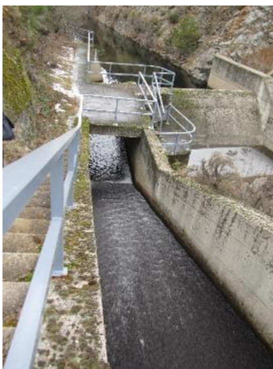
Canal de trasvase desde el Cuerpo de Hombre y aliviadero presa de Navamuño
