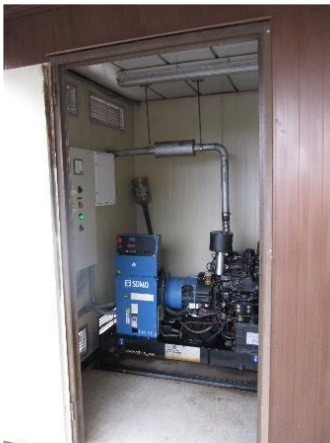
Grupo electrógeno presa de Navamuño
