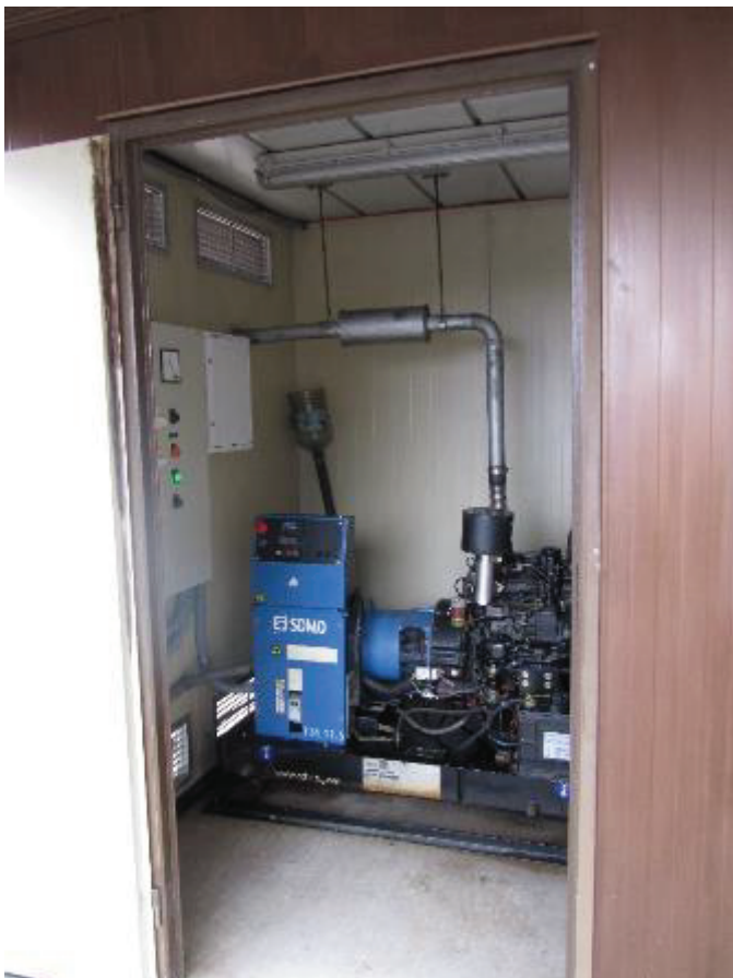
Grupo electrógeno presa de Navamuño
