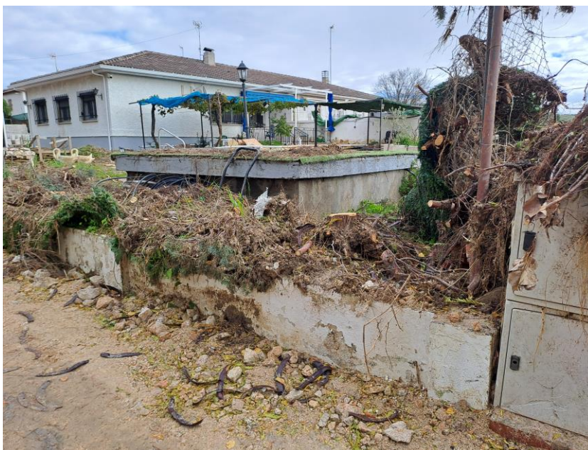
Figura 14: Daños en viviendas en Villamanta durante la DANA de septiembre de 2023
