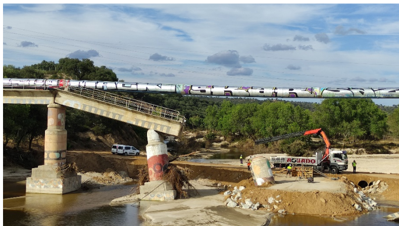
Puente afectado de la conducción Picadas-Toledo
