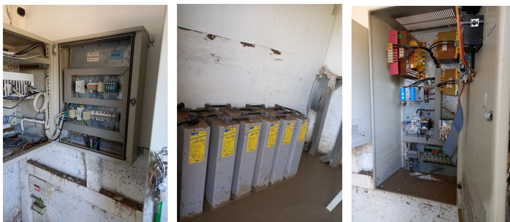
Daños sufridos en la estación AR20
