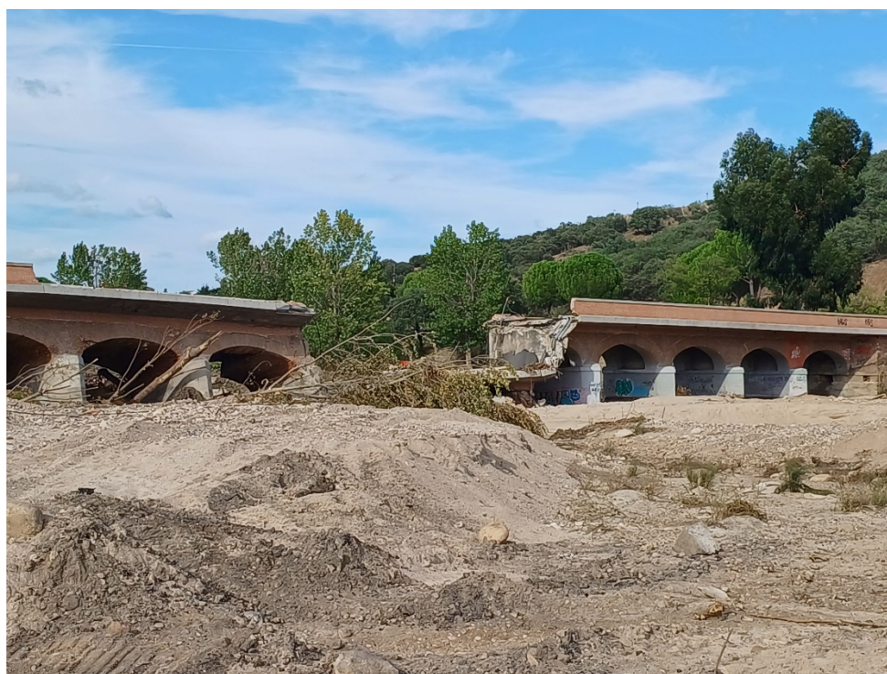
Puente de la Pedrera. Situación tras el paso de la dana.
