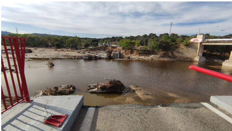
Puentes afectados en el río Perales
