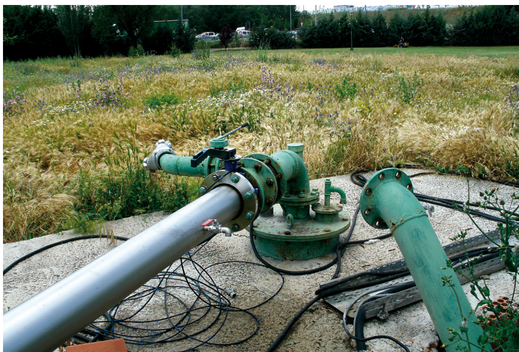
Ilustración 5. Detalle de sondeo con bomba instalada
