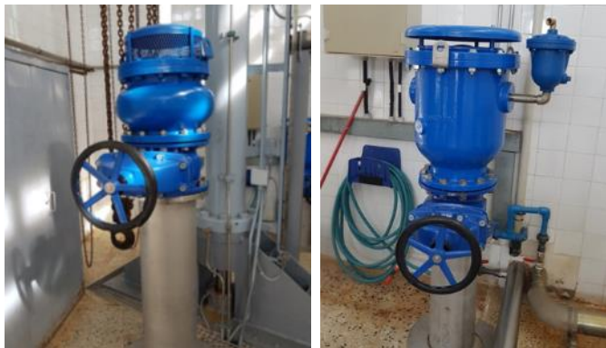
Fotografía 17. Válvulas Howell Bungers de la presa de Borbollón
