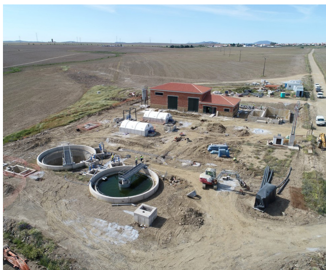
Foto 85. EDAR de la Cumbre
