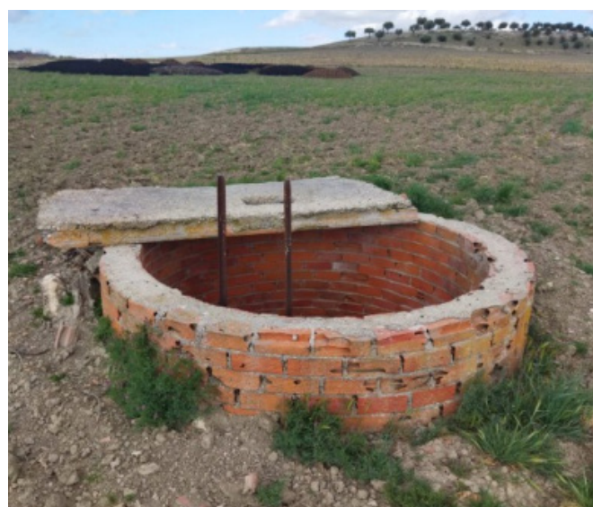
Foto 43. Pozo abandonado con riesgo de caída
