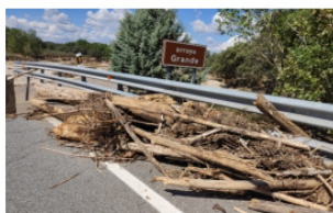
Restos de la avenida en el puente roto
