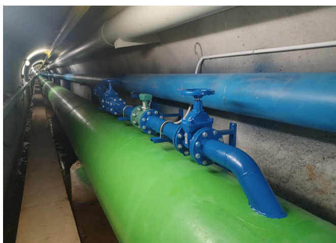
Fotos 95 y 96. Caudalímetros y tomas de caudal ecológico en la presa de Torrejoncillo.
