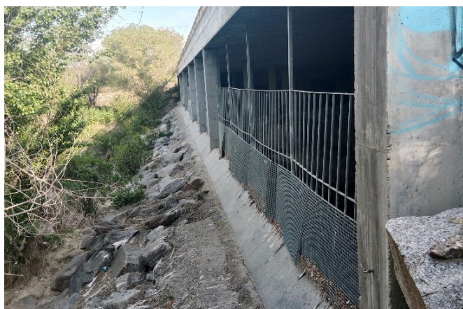
Foto 30. Punto de vertido por desbordamiento asociado a una EDAR
