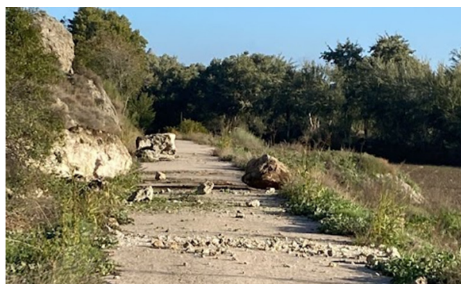
Foto 51. Estado del camino antes de las actuaciones. Inmediaciones de la presa del Rey.
