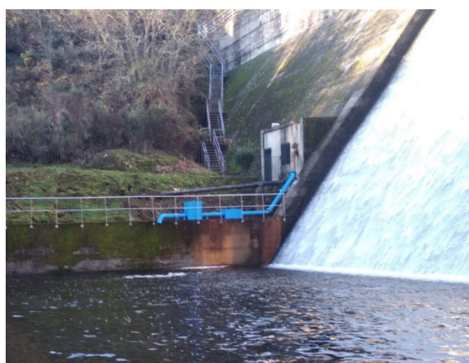
Foto 93. Caudalímetros y tomas de caudal ecológico en la presa de Villanueva de la Vera.
