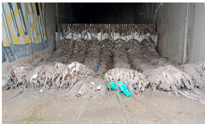
Foto 31. Sistema de retención de sólidos y flotantes en un punto de vertido
