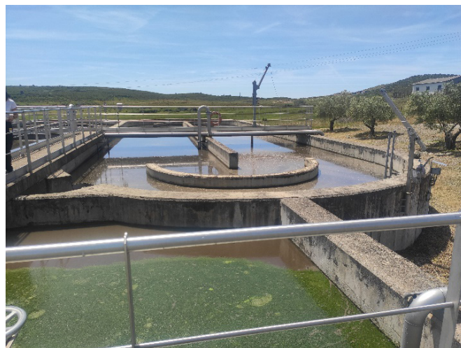
Foto 25. Instalaciones de depuración
