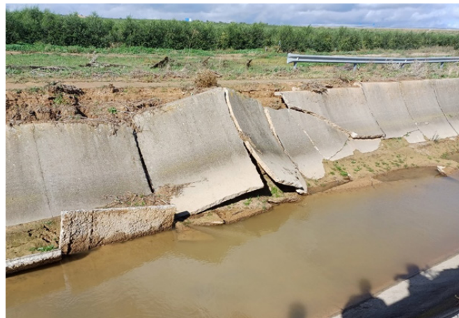
Foto 58. Estado del canal tras la DANA. Canales de Aranjuez
