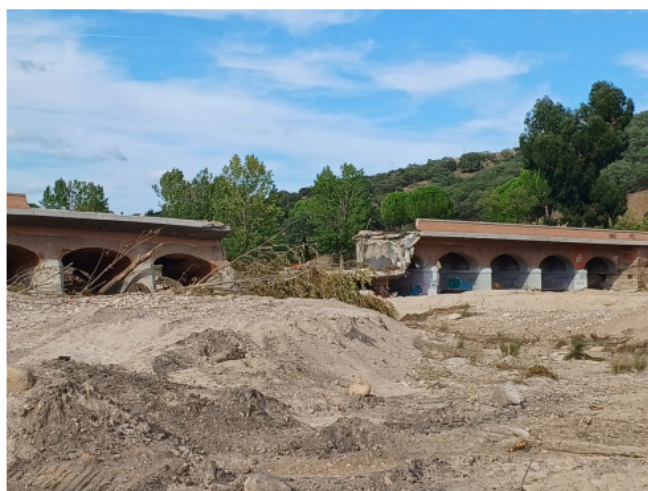
Foto 35. Rotura del Puente sobre el Arroyo Grande y Puente de la Pedrera
