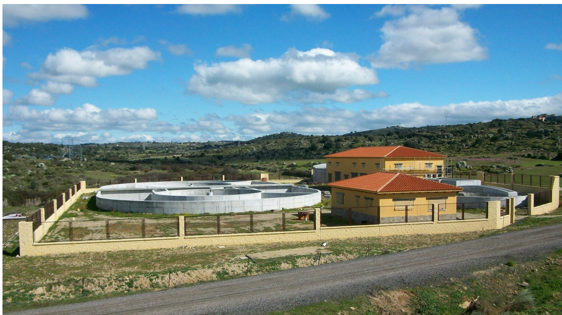
EDAR Trujillo; Cáceres
