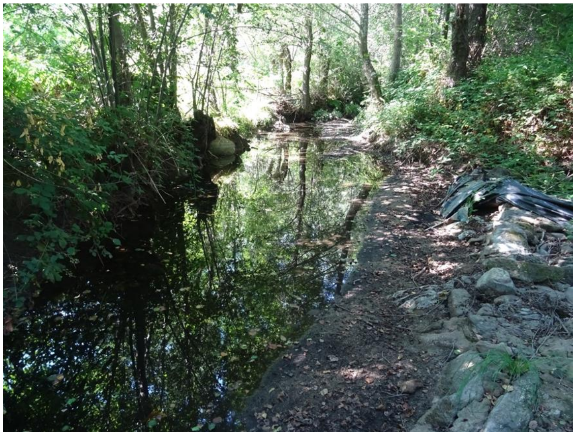
Azud de totalmente colmatado en parte media de la zona 3
