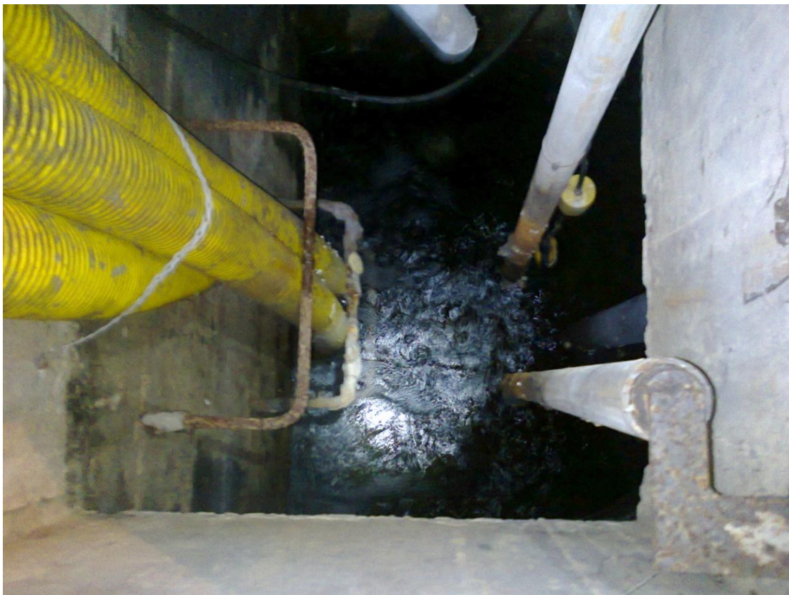
Foto 27. Punto en el que se vierte el agua extraída en el Palacio de Congresos (canalización de aguas pluviales de la red de saneamiento) (20/03/12).
