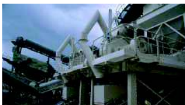
Ilustración 71: Sistema de aspiración de polvo
